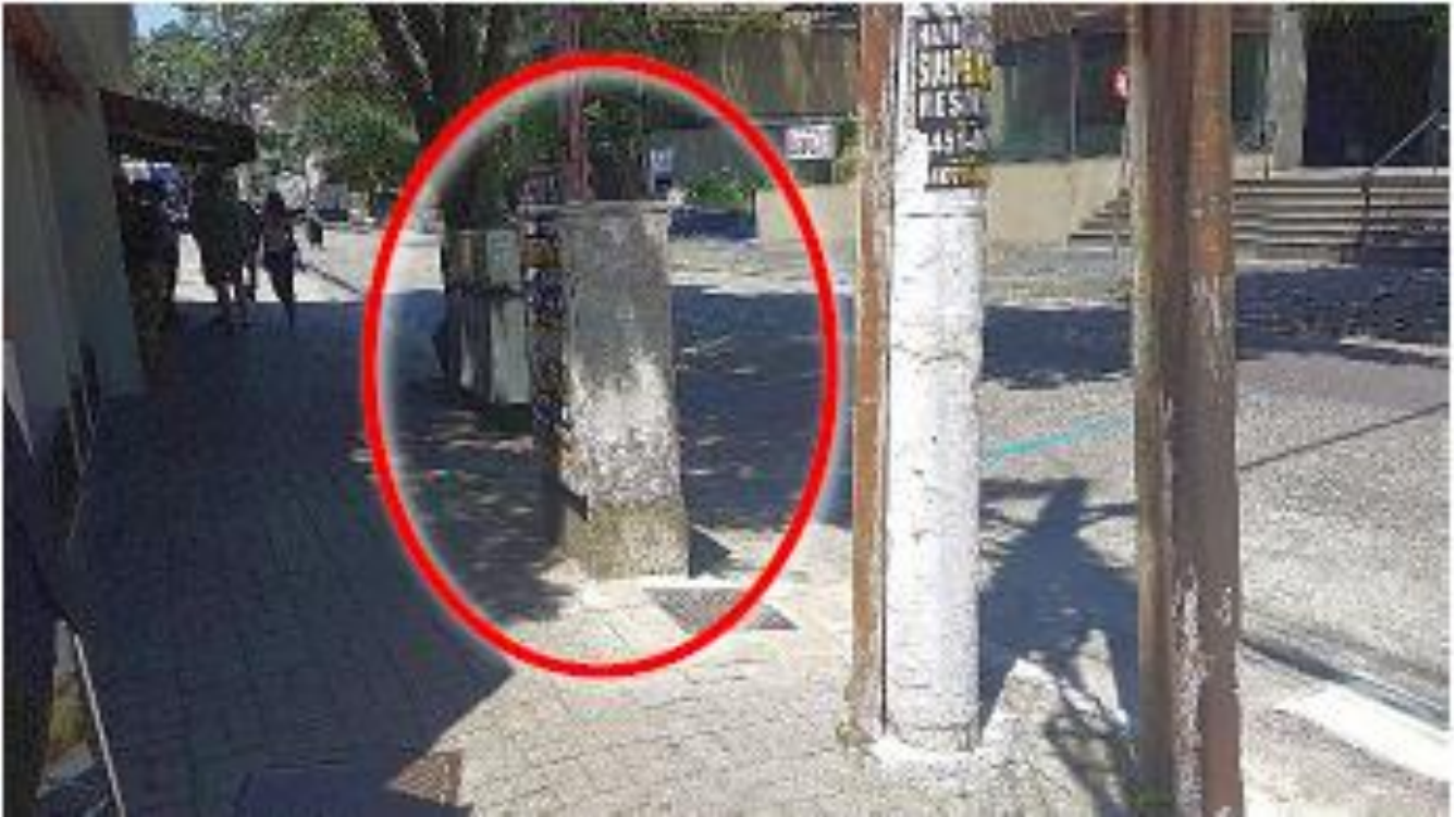
Figura 12: Controlador ST900, próximo ao n° 1200 da R. Bela Cintra, esquina com Al. Santos
