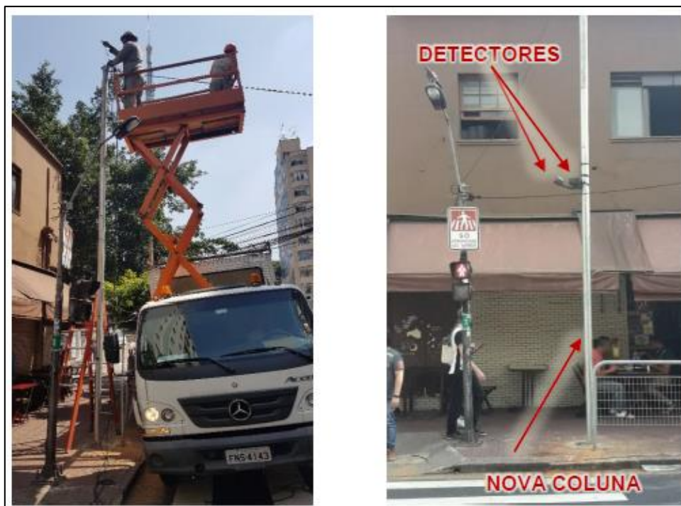
Figura 14: Imagens da implantação de colunas de sustentação, cabeamento e instalação dos detectores de pedestres
